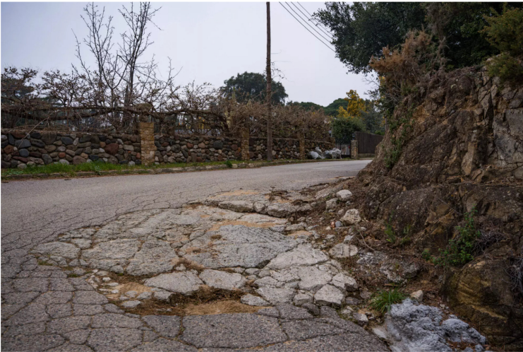
Urbanización Castellar d'Índies, en Sant Cebrià de Vallalta, con deficiencias urbanísticas: terrenos sin asfaltar o mal asfaltados, problemas de alumbrado público, desprendimientos y falta de una red de alcantarillado. / MARC ASENSIO CLUPES / EPC
